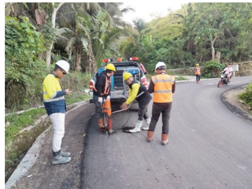
Infrastruktur: Perbaikan jalan desa yang rusak di sekitar Dusun Hele, Desa Hulawa.
